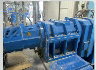
Extruder im laufenden Betrieb
