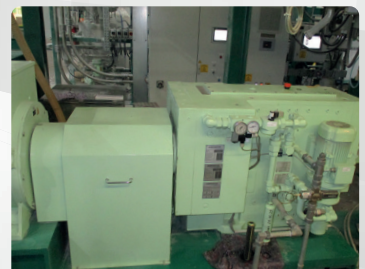
Extruder im laufenden Betrieb
